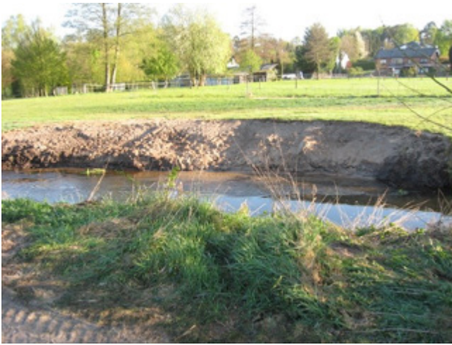
Abb. 2.6: Böschungserosion an der Este (M. Deckwerth)
